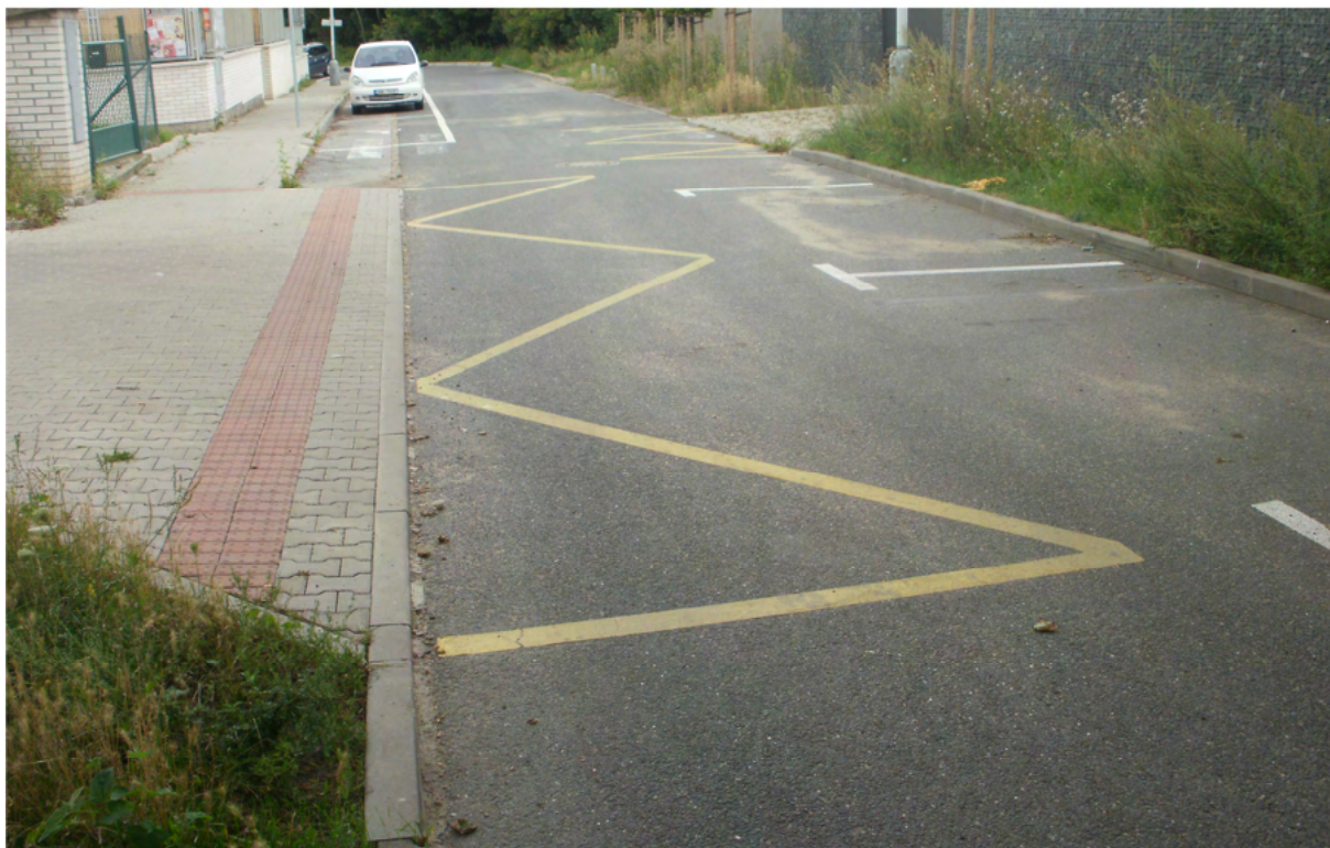
Obrázek 11: Nevhodně provedený varovný pás u výjezdu z parkoviště na ulici Šímanovské
