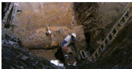
...a právě to pro opraváře znamenalo největší komplikaci při odstraňování havárie.
