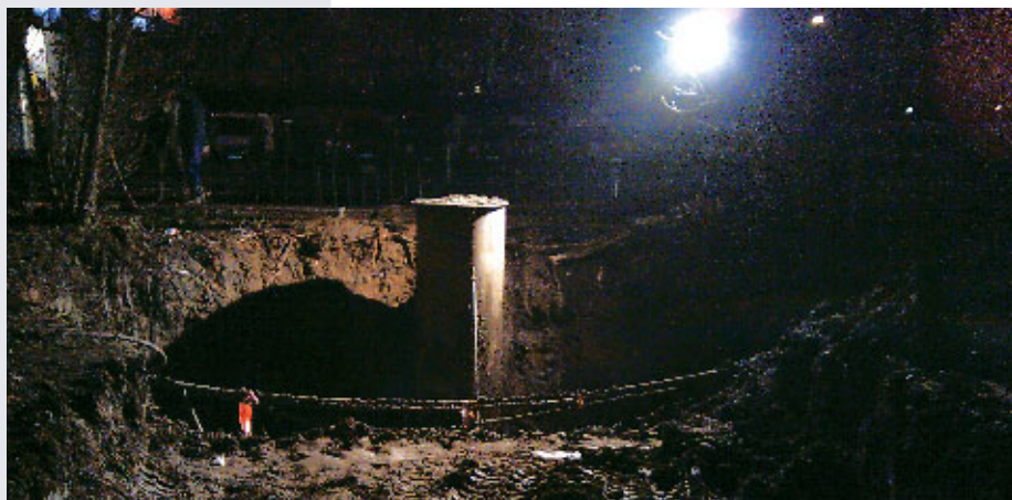
Vodovodní potrubí v Českobrodské ulici prasklo podle vyjádření PVK vlivem koroze a teplotních změn. Díky signalizaci odhalili vodohospodáři havárii takřka okamžitě.
