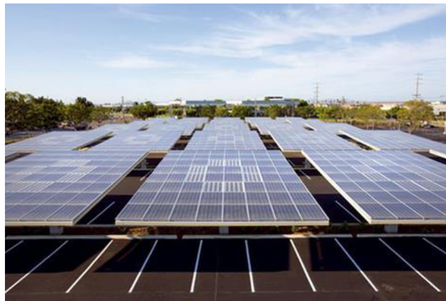
Stínění pomocí FVE panelů. ( https://www.asb-portal.cz/stavebnictvi/technicka-zarizeni-budov/fotovoltaika/solarni-parkoviste-vice-uzitku-zjedne-instalace )
