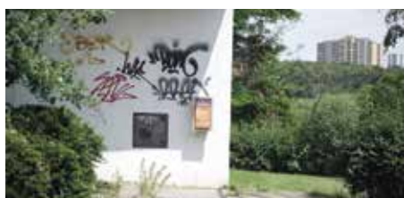
Sprejři se neomezují jen na fasády domů a zdi, lákavé jsou i poštovní schránky, rozvodné skříně či cedule
