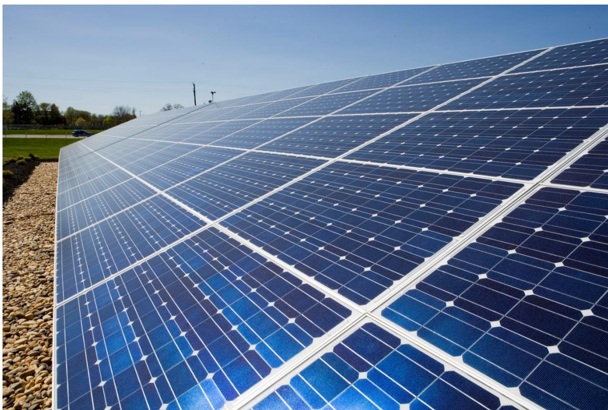
Obrázek 50 Detail Solárních fotovoltaických systémů
