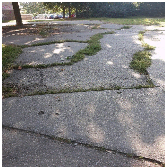
Obrázek 26 - Špatný stav chodníků (v blízkosti ulice Rochovská)
