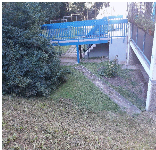
Obrázek 12 - Nesprávné řešení ochrany před přívalovými dešti_2 (v blízkosti obytného domu Rochovská 497)
